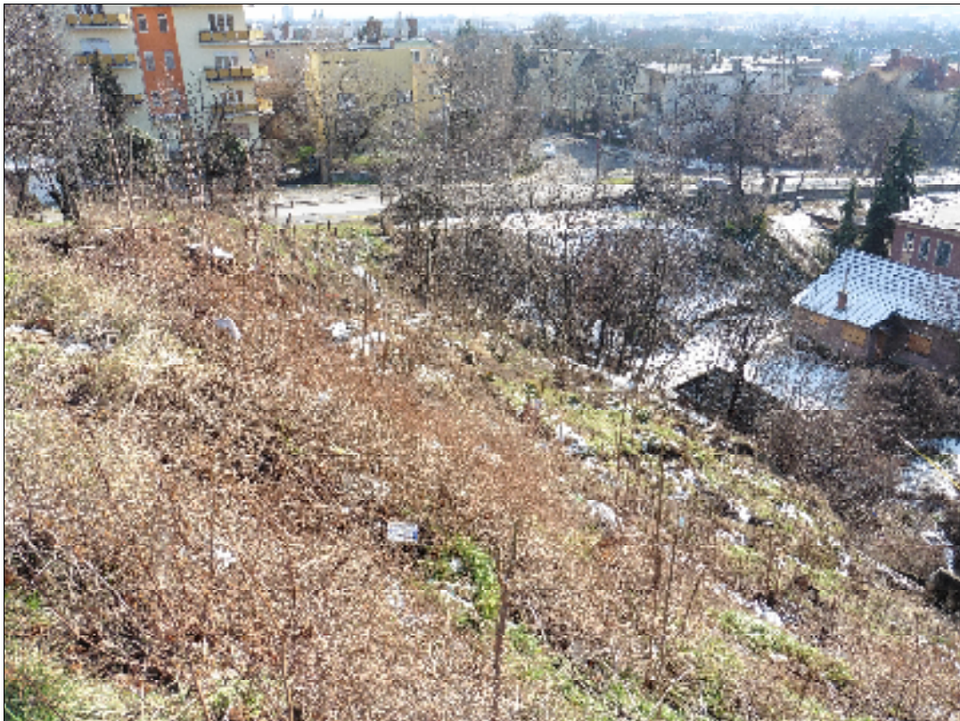
13. kép: A rézsű talpvonaláig lecsúszott földtömeg
