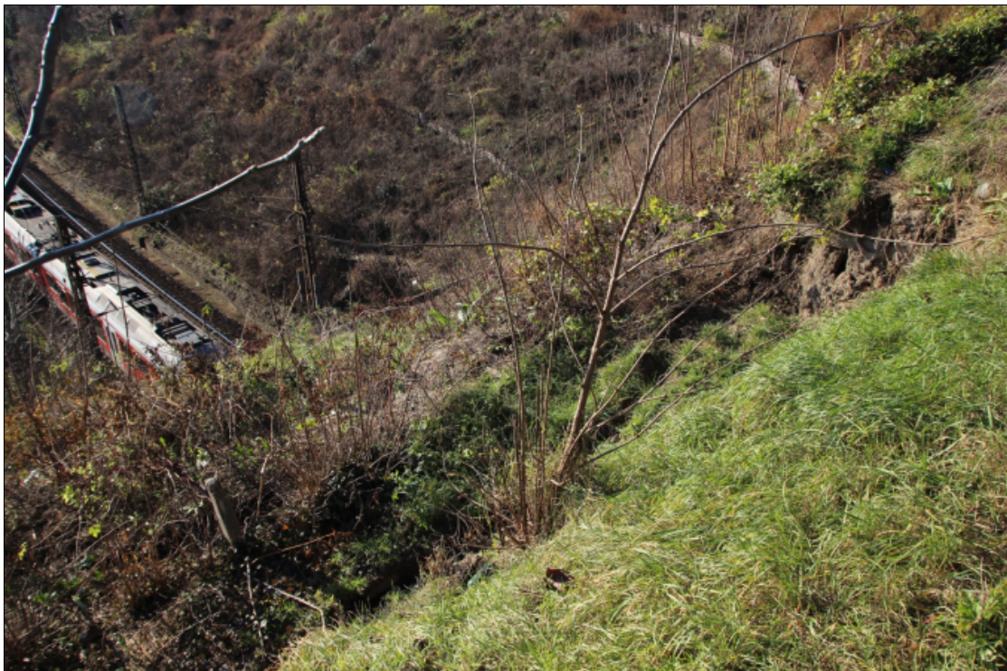
29. kép: A megcsúszott rézsú (2015. 12.21.-én készített, környékbeli lakostól kapott kép)
