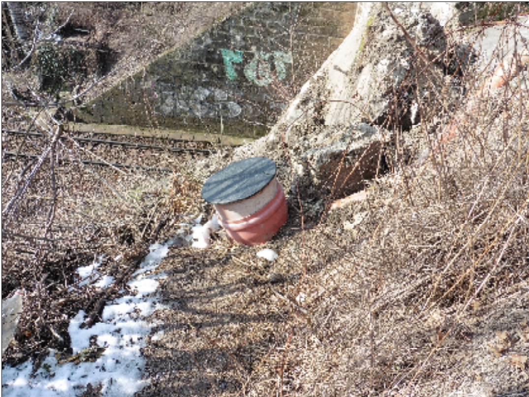
18. kép: A kapuzat környezetében megsérült szivárgó rendszer
