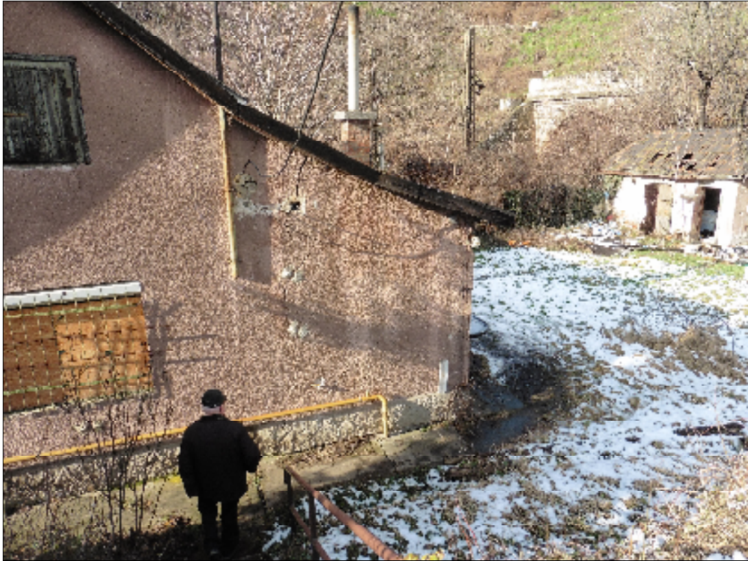
20. kép: A MÁV Zrt. területén lévő-, észak-keleti sarkán megsüllyedt épület
