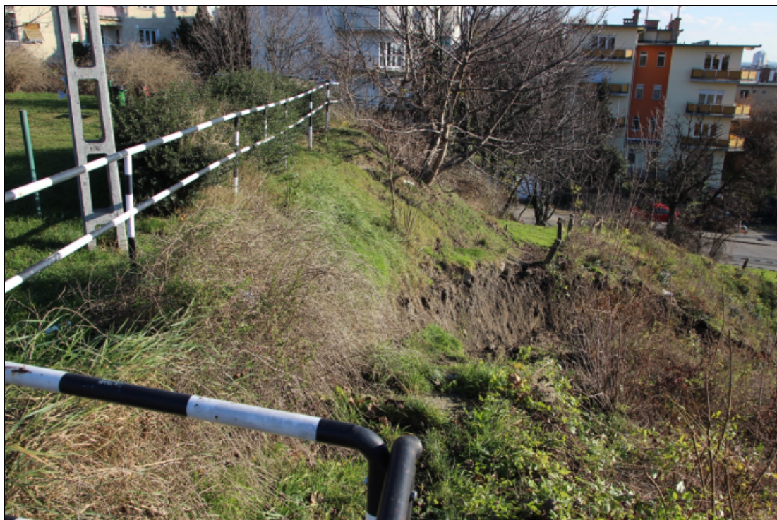
30. kép: A megcsúszott rézsú (2015.12.21.-én készített, környékbeli lakostól kapott kép)
